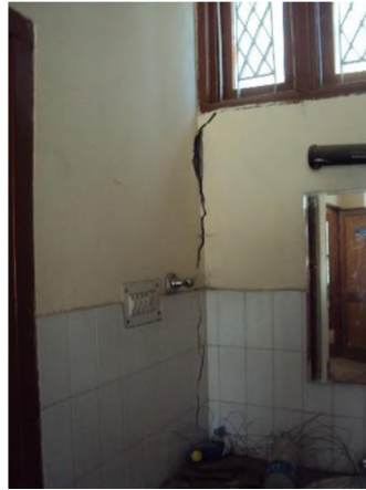
Fig.: wall cracks
