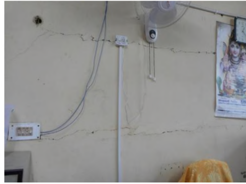
Fig.: Wall Crack
