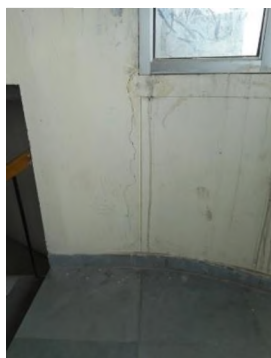
Fig.: Wall Cracks
