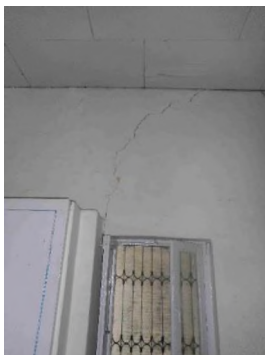
Fig.: Wall Cracks 1
