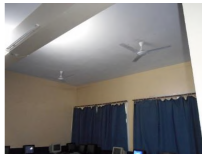
Fig.: Ceiling Fan
