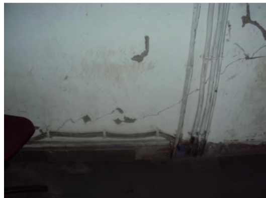
Fig.: Wall Cracks
