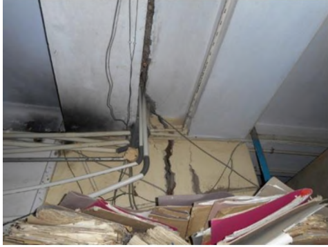
Fig.:Joint Crack (ii)
