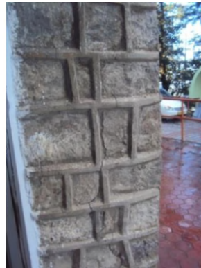
Fig.: Wall Cracks
