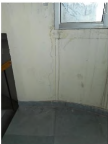
Fig.: Wall Cracks
