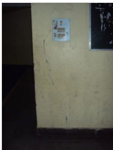
Fig.: Wall Crack
