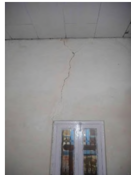
Fig.: Wall Cracks 2
