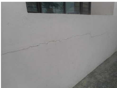
Fig.: Wall Cracks
