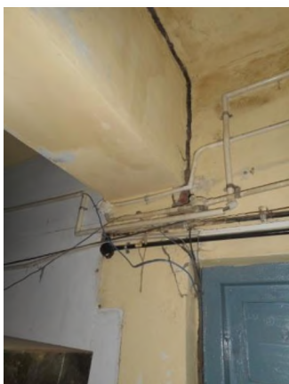
Fig.:Joint crack (ii)
